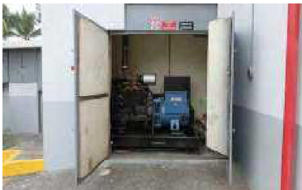
Fotografía 15: Grupo electrógeno Partner.
