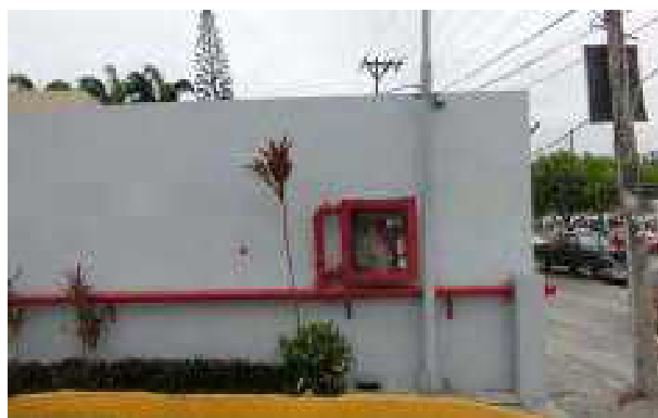
Fotografía 18: Boca contra incendios en la estación de servicio.
