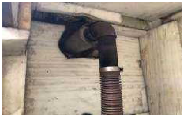
Fotografía 16: Chimenea para el generador eléctrico.
