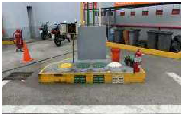
Fotografía 10: Bocas de llenado de combustibles.
