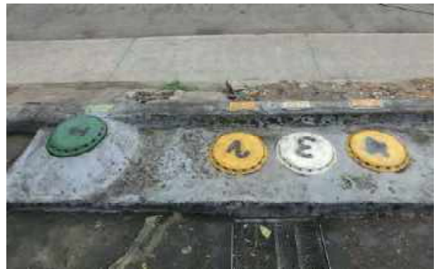
Fotografía 10: Bocas de llenado de combustible.
