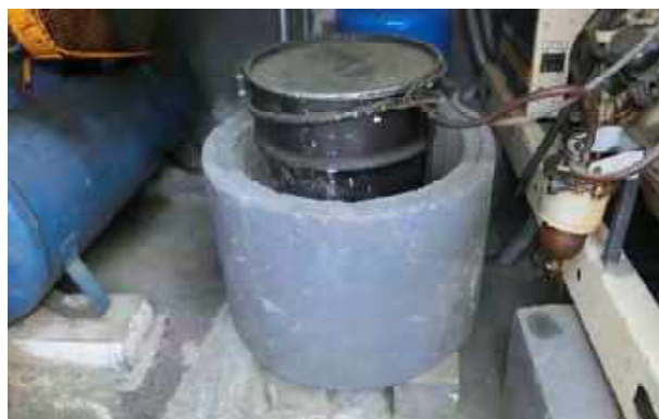
Fotografía 20: Berma de seguridad para el tanque de combustible para el generador eléctrico.
