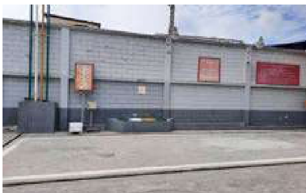
Fotografía 11: Sistema segregado de drenaje del área de tanques.
