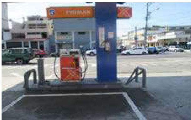
Fotografía 15: Dispensador de combustibles con extintor y señalética de seguridad. (2019).
