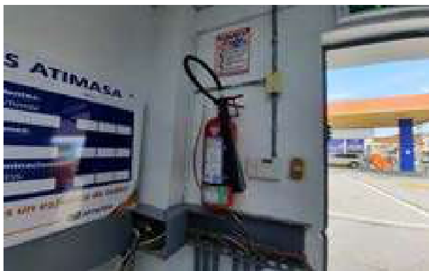
Fotografía 19: Extintor en el área de generador.
