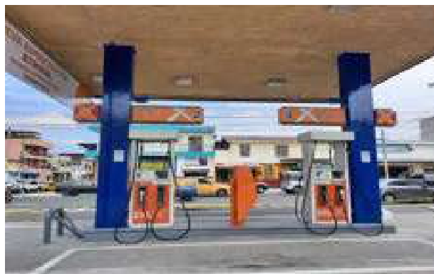
Fotografía 16: Dispensador de combustibles no operativo. (2019).
