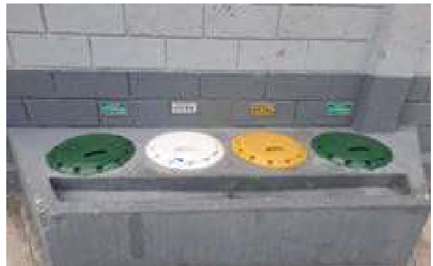
Fotografía 10: Bocas de llenado de combustibles.
